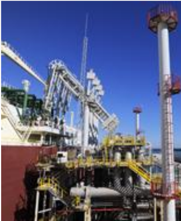
Bracci di scarico del GNL
